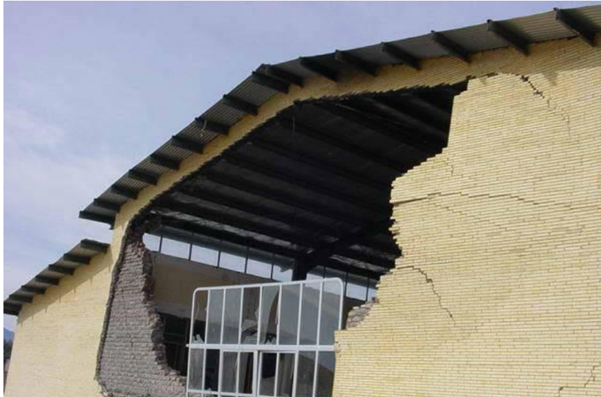
شکل ۵- خرابی در اثر عدم اتصال صحیح نما به دیوار در حین زلزله بم (۱۳۸۲)
