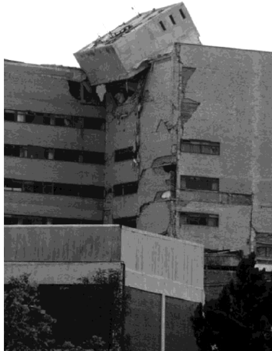
شکل ۳- شکست در خرپشته یک بیمارستان در حین زلزله مکزیک (۱۹۸۵)
