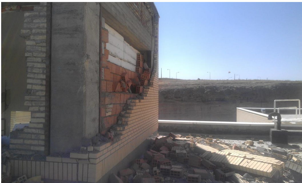
شکل ۴- خرابی در نمای یک ساختمان در حین زلزله ورزقان و اهر (۱۳۹۱)
