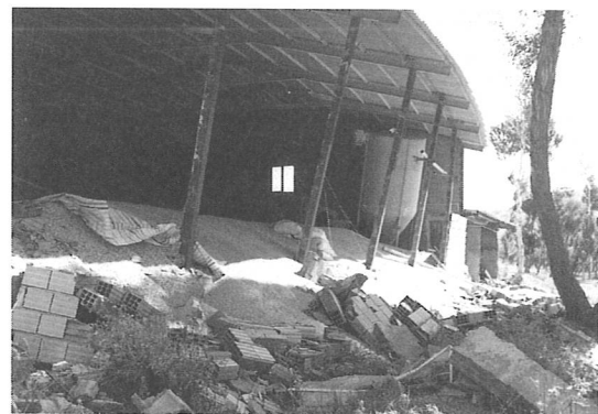
شکل ۱۰- کمانش ستون های فولادی یک انبار
