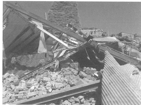
شکل ۹- انهدام دو ساختمان با اسکلت فولادی در منطقه آسیب دیده از زلزله
