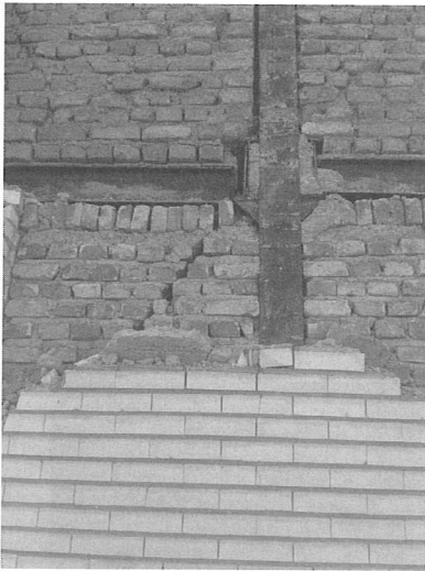
شکل ۱۱- اتصال نامناسب تیر فرعی به تیر اصلی در یک اتصال خورجینی
