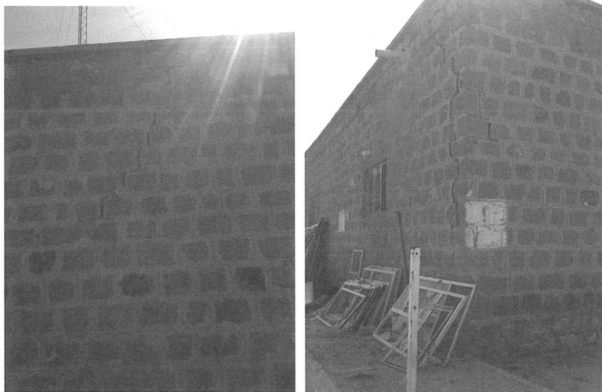
شکل ۶- ترک‌خوردگی دیوار یک ساختمان سنگی در گوشه آن
