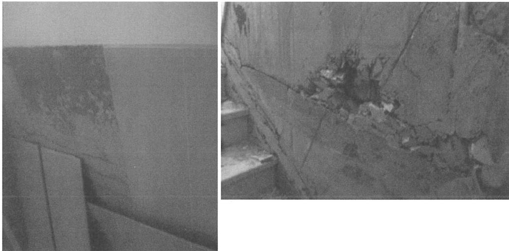
شکل ۱۲- بیمارستان ورزقان، جدا شدن پلاک‌های سنگ در فضای داخلی
