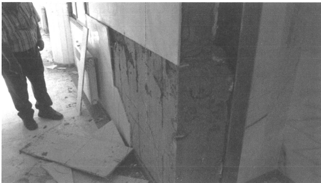
شکل ۱۴- بیمارستان هریس، اجرای نامناسب درز انقطاع
