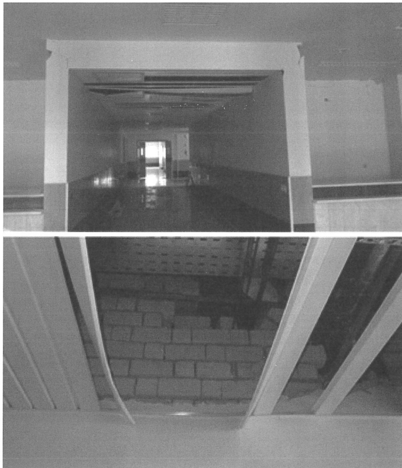
شکل ۱۳- بیمارستان هریس، خرابی سقف‌های کاذب بالا: ناپایداری کمانشی ورق‌های سقف کاذب پایین: سقوط بلوک‌های سیمانی و تخریب سقف کاذب
