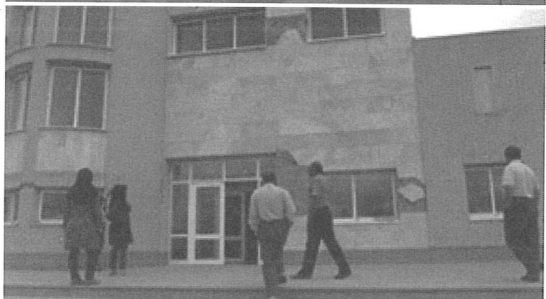
شکل ۶- آسیب‌های وارد بر نمای بیمارستان ورزقان بالا: ترک خوردگی قطری در نمای آجری پایین: کنده شدن و افتادن پلاک‌های سنگ
