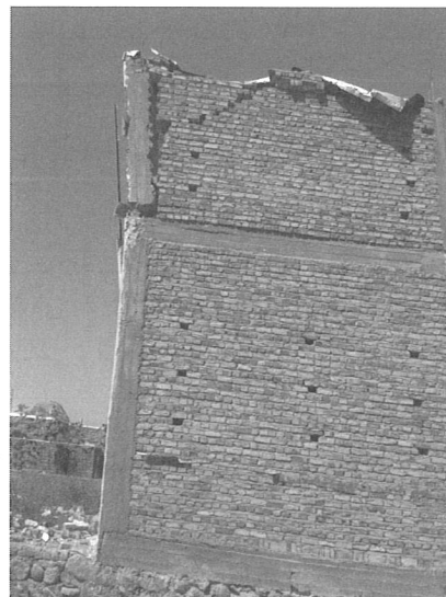
شکل ۱۳- شکست ستون در محل اتصال
