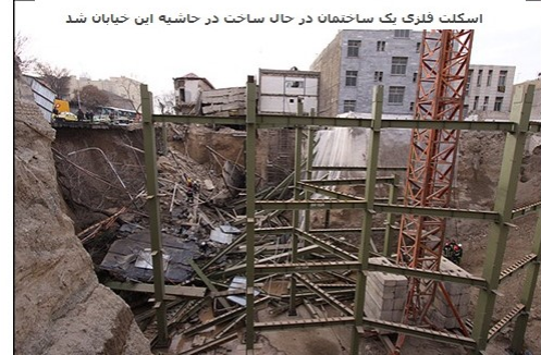
ME گودبرداری غیر اصولی موجب نشست بخشی از خیابان ری تهران و فرو ریختن
