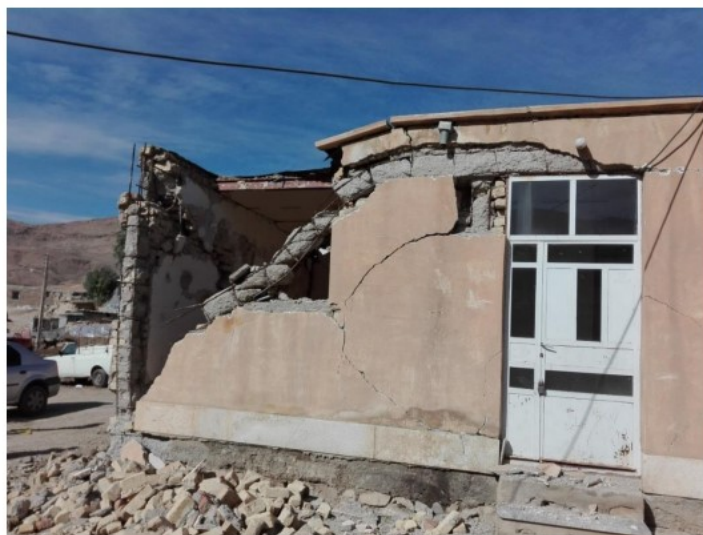
شکل (۶-۱۵): تابیدگی، شکستگی، صدمه دیدگی شدید در دیافراگم یک ساختمان مصالح بنایی
