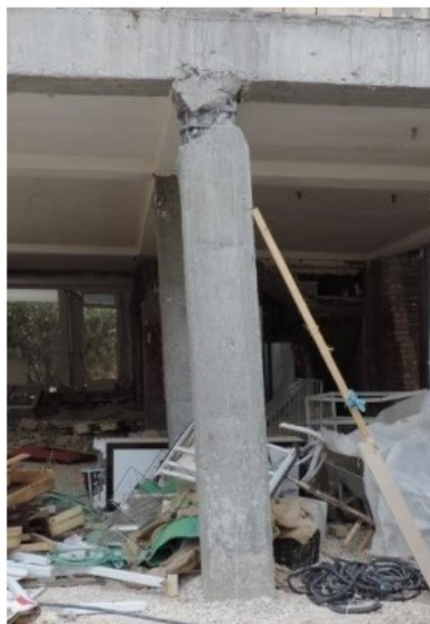
شکل (۹-۵): نمونه‌ای از آسیب ستون یا شکل‌گیری مفصل پلاستیک در بخش فوقانی
