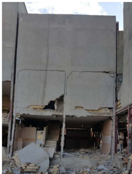
شکل (۴-۳۱): کج شدن محسوس ستون‌ها و دیوارها
