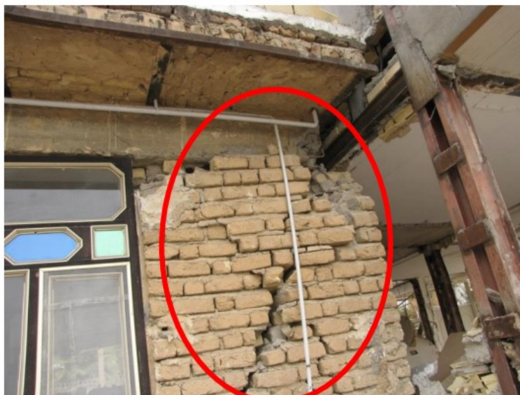
شکل (۶-۸): خرابی در سیستم باربر قائم در یک ساختمان مصالح بنایی بدون کلاف
