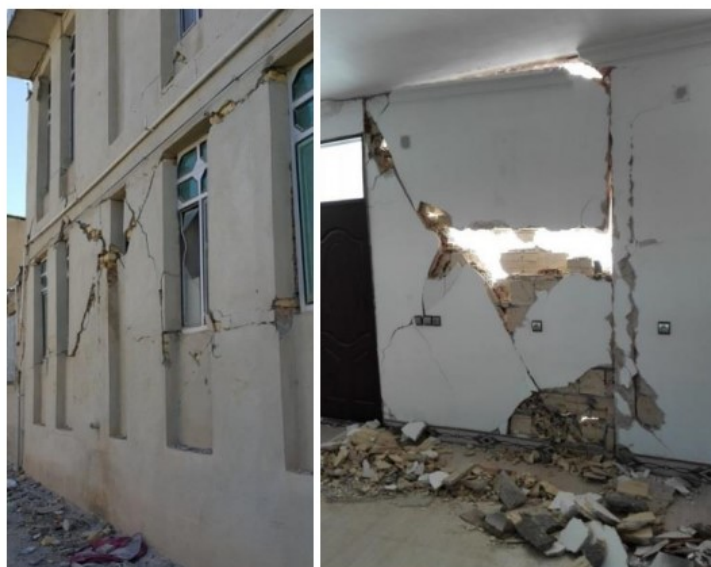
الف) آسیب در دیوارهای جداکننده داخلی ب) آسیب در دیوارهای جداکننده پیرامونی شکل (۳-۸): آسیب وارده و خطر فروریزش دیوارهای جداکننده
