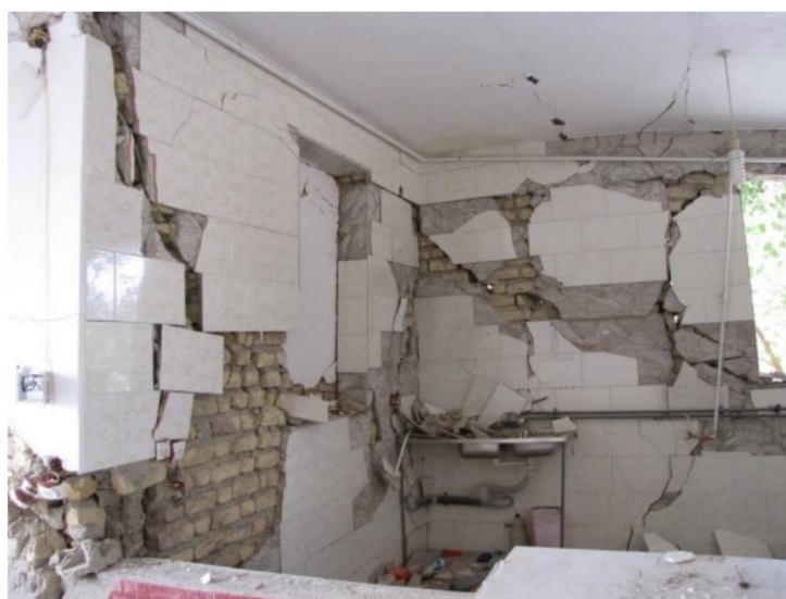
شکل (۶-۱۴): دیوارهای با ترک مورب پله‌ای شکل بزرگ در یک ساختمان مصالح بنایی بدون کلاف
