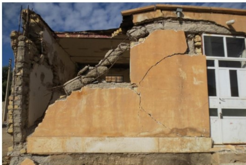
شکل (۶-۲۸): فروریزش دیوار یک ساختمان مصالح بنایی کلاف دار
