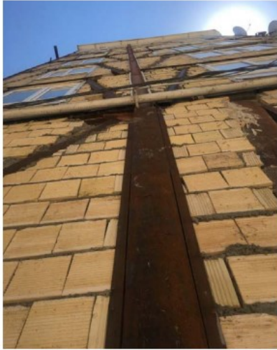
شکل (۳-۴): کج شدن و جابجایی ماندگار در ساختمان
