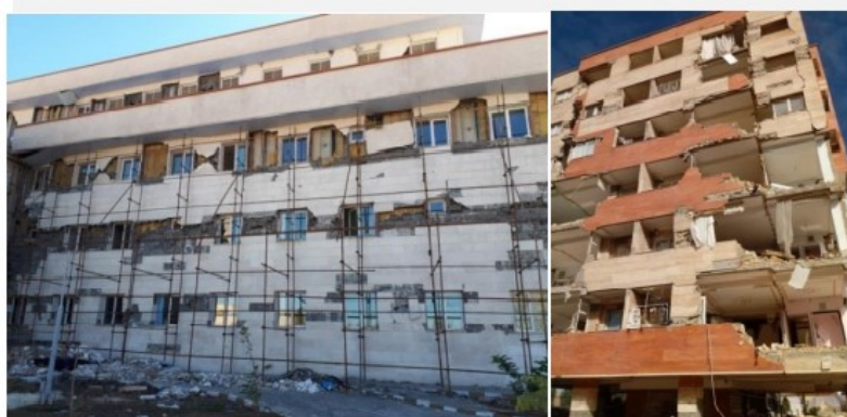
شکل (۱-۸): خطر فروریزش نمای ساختمان
