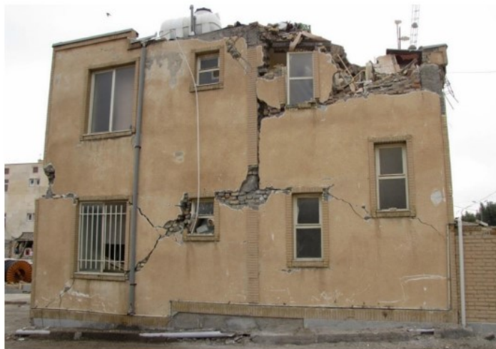
شکل (۶-۱۹): فروریزش موضعی در یک ساختمان مصالح بنایی کلاف دار
