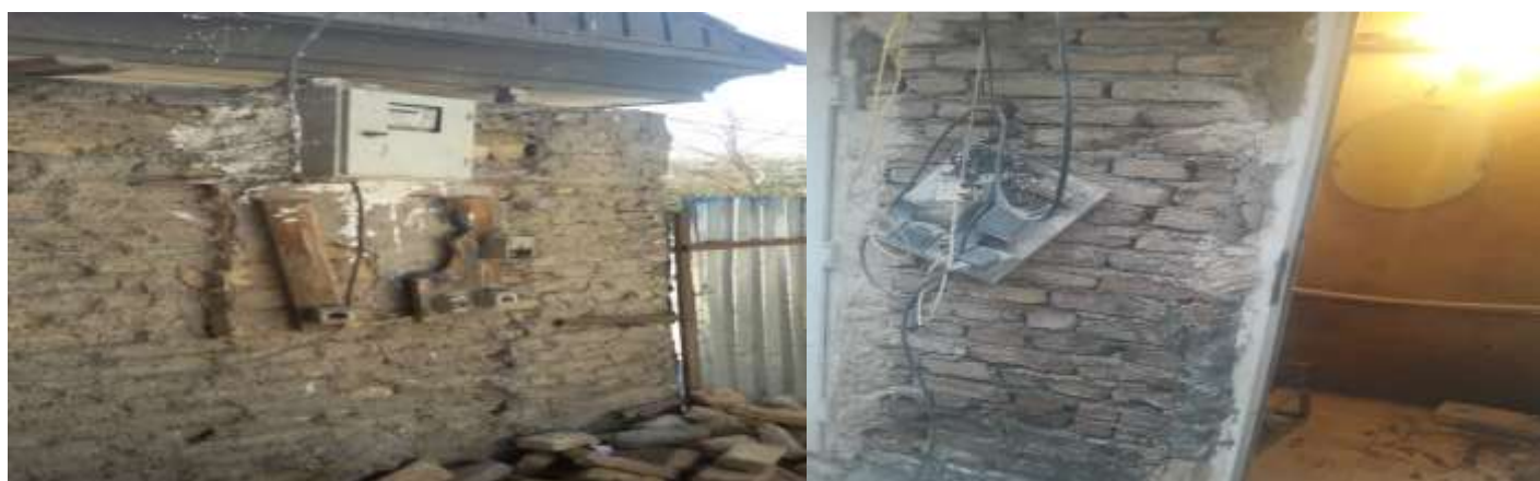
شکل ۵-۵ و ۵-۶ ریسک بالای ادوات برقی و وضعیت نامناسب برق کارگاه
