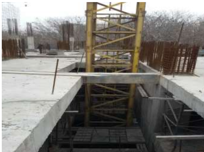
اشکال ۵-۸ و ۶-۸- عدم وجود نرده حفاظتی مناسب برای پرتگاه ها
