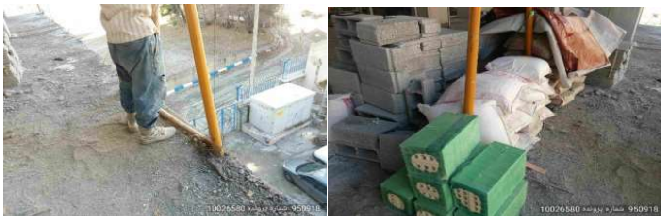
شکل ۹-۶ و ۱۰-۶ - نحوه نامناسب استقرار پایه های بالابر وعدم اتصال و فیکس نمودن آنها
