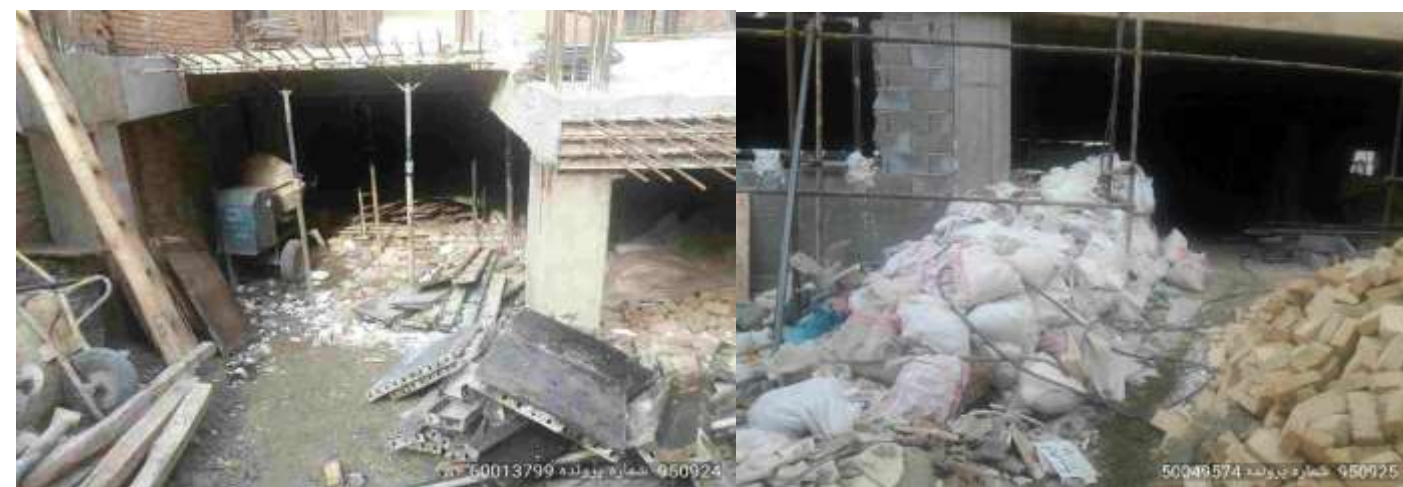
اشکال ۱۲-۵- ۱۲-۶- مربوط به بی نظمی کارگاه و وضعیت نامناسب دیو نخاله ها و مصالح و وضعیت نایمن ۵S
