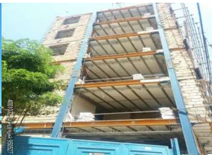
شکل ۱۵-۲ عدم اجرای نرده حفاظتی و پاخور پرتگاه های طبقات
