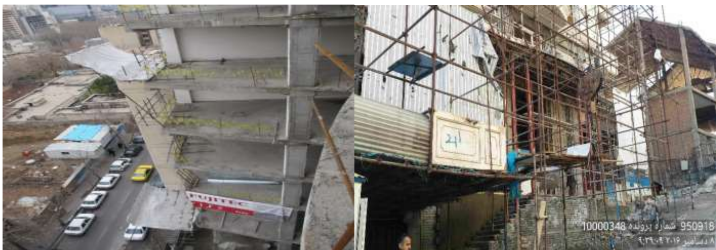
اشکال ۹-۱۳ و ۱۰-۱۳- عدم اجرای پوشش مناسب و ایمن نما
