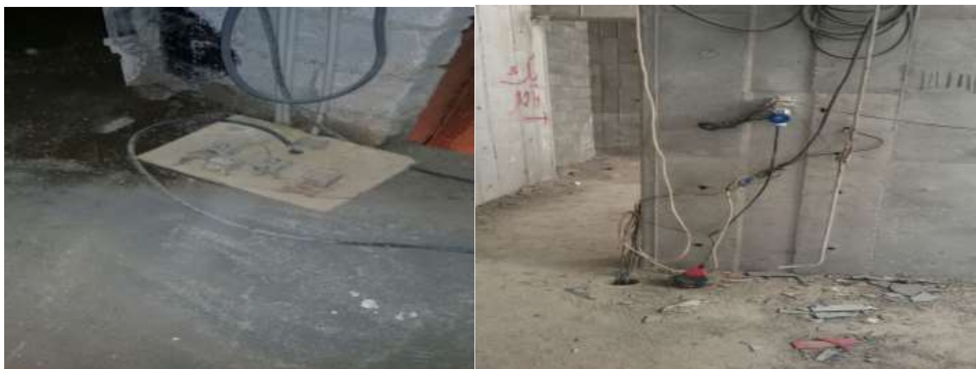
شکل ۵-۳ و ۵-۴ خطرات برق گرفتگی و وضعیت نامناسب سیستم برق رسانی کارگاه
