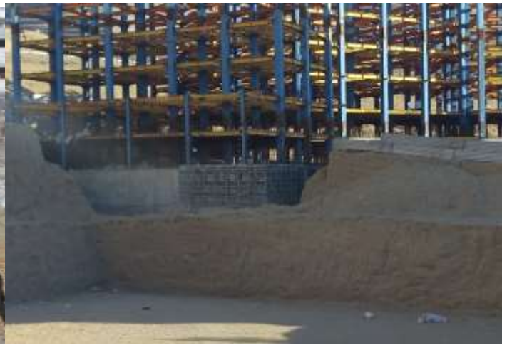
شکل ۱۹-۲ عدم اجرای نرده حفاظتی و پاخور پرتگاه های طبقات
