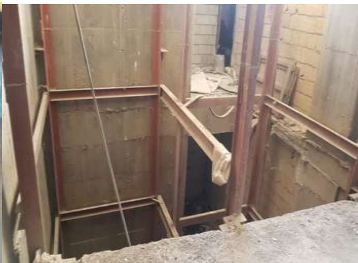
اشکال ۷-۸ و ۸-۸- عدم وجود نرده حفاظتی مناسب برای پرتگاه ها
