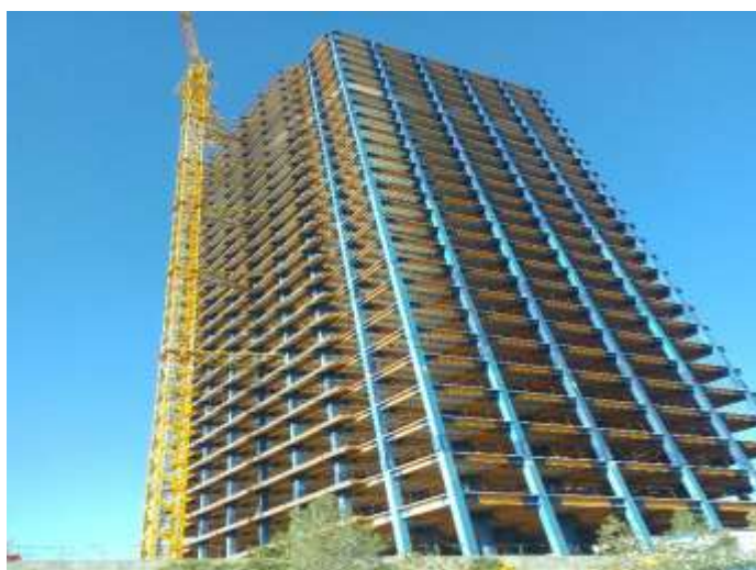
شکل ۱۶-۲ عدم اجرای نرده حفاظتی و پاخور پرتگاه های طبقات
