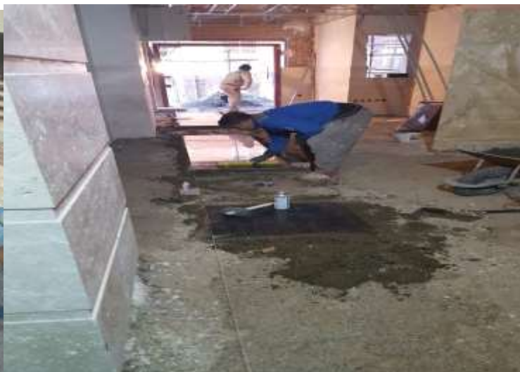
اشکال ۴-۹ و ۴-۱۰- عدم استفاده از تجهیزات حفاظت فردی مناسب
