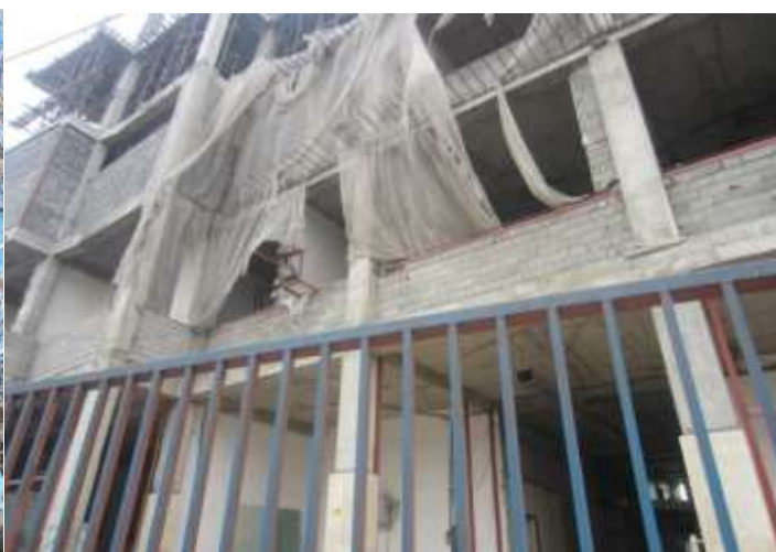
اشکال ۱۷-۱۳ و ۱۸-۱۳ - عدم اجرای پوشش مناسب و ایمن نما
