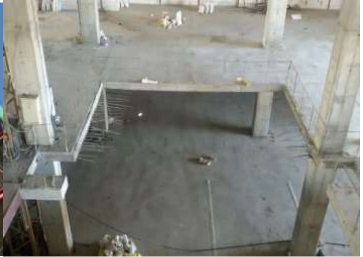
شکل ۲-۱ عدم حفاظ مناسب باز شو طبقات
