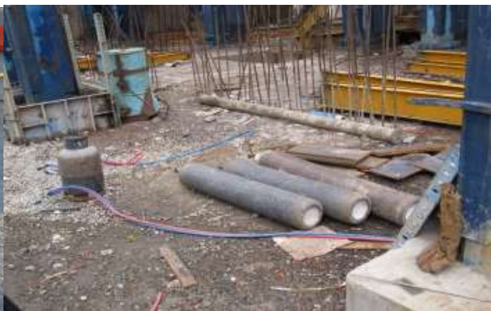
اشکال ۱۱-۷ و ۱۱-۸ وضعیت نامناسب و نایمن نگهداری از کپسولهای اکسیژن
