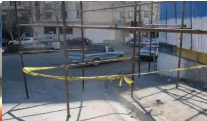
شکل ۱-۵ مسدود کردن پیاده رو وعدم اجرای راه دسترسی موقت
