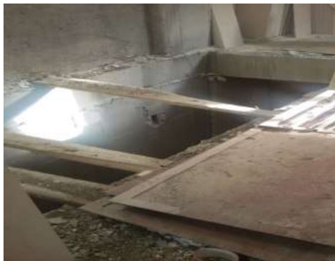
اشکال ۹-۸ و ۱۰-۸- عدم وجود نرده حفاظتی مناسب برای پرتگاه ها
