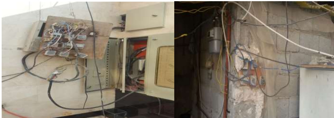
شکل ۵-۱ و ۵-۲ مربوط به خطرات برق گرفتگی و نایمنی ادوات برقی
