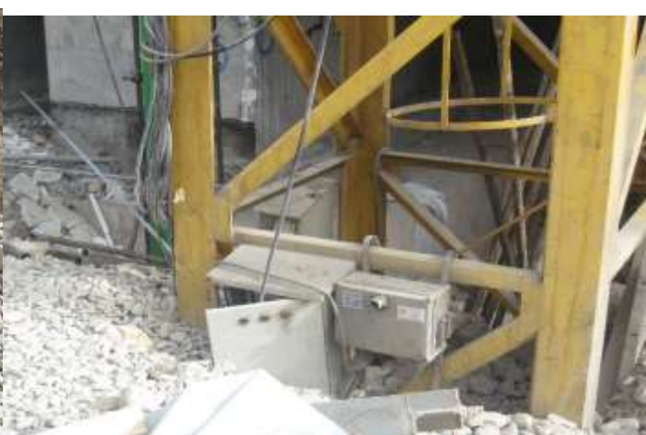
اشکال ۵-۱۰ و ۶-۱۰ وضعیت پرریسک تابلوهای تاورکین و سیستم برق تاور
