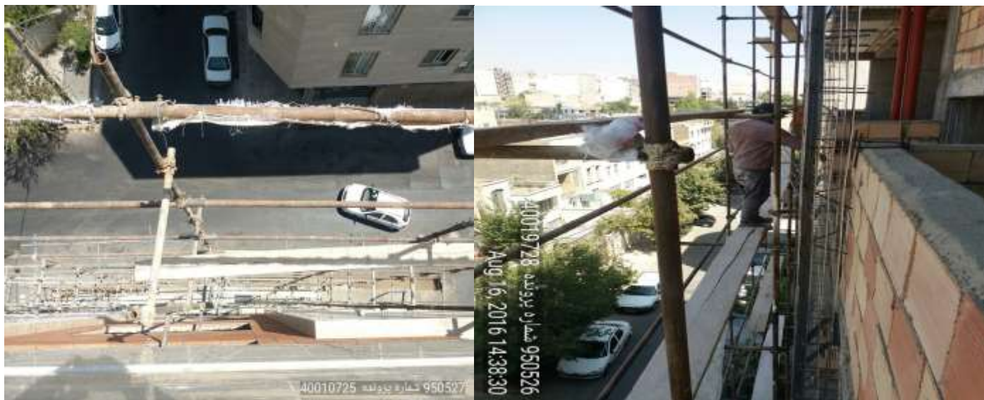
اشکال ۱۳-۳ و ۱۴-۳- وضعیت پرریسک کار در ارتفاع و چوب بستهای ترک خورده ولق وعدم بستن تخته های زیرپایی وعدم اجرای پاخور وحفاظ
