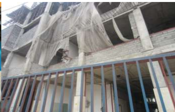
اشکال ۱-۱۳-۲- عدم اجرای پوشش مناسب نما و سرپوش و سپر محافظتی ایمن
