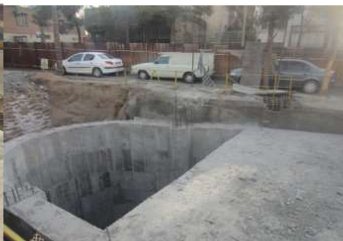
شکل ۲-۱۱ عدم اجرای نرده حفاظتی
