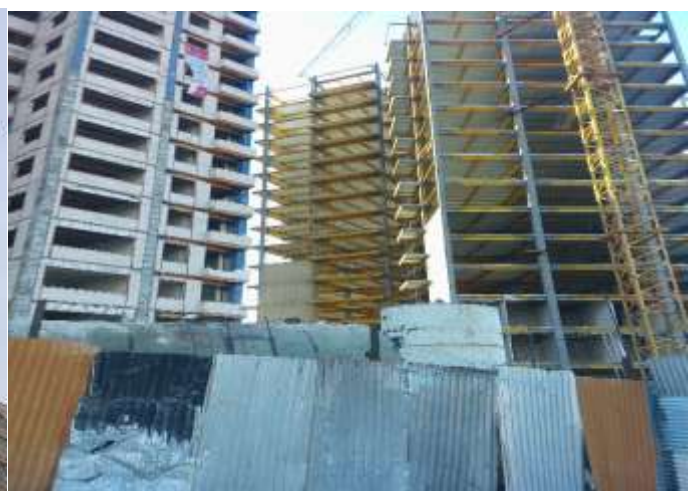
شکل ۲۳-۲ عدم اجرای نرده حفاظتی و پاخور پرتگاه های طبقات
