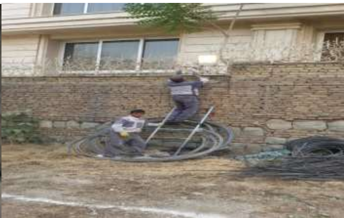
اشکال ۵-۴- و ۶-۴- عدم استفاده از تجهیزات حفاظت فردی مناسب
