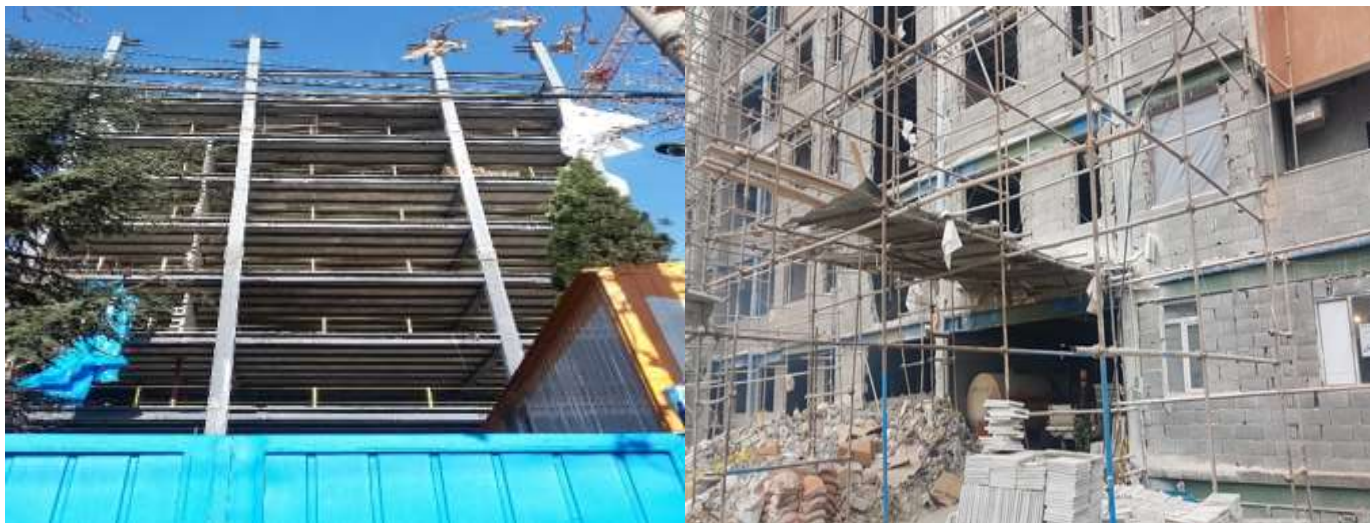
اشکال ۱۱-۱۳ و ۱۲-۱۳- عدم اجرای پوشش مناسب و ایمن نما
