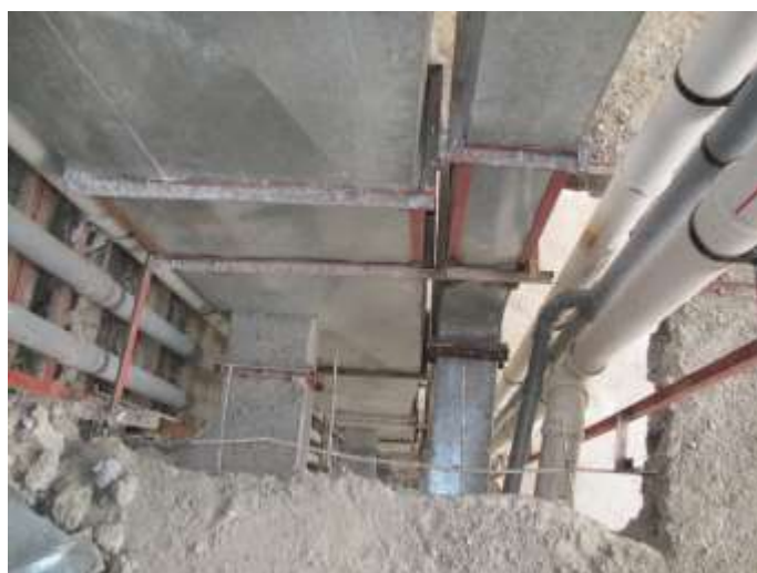
شکل ۱۸-۲ عدم اجرای نرده حفاظتی و پاخور پرتگاه های طبقات
