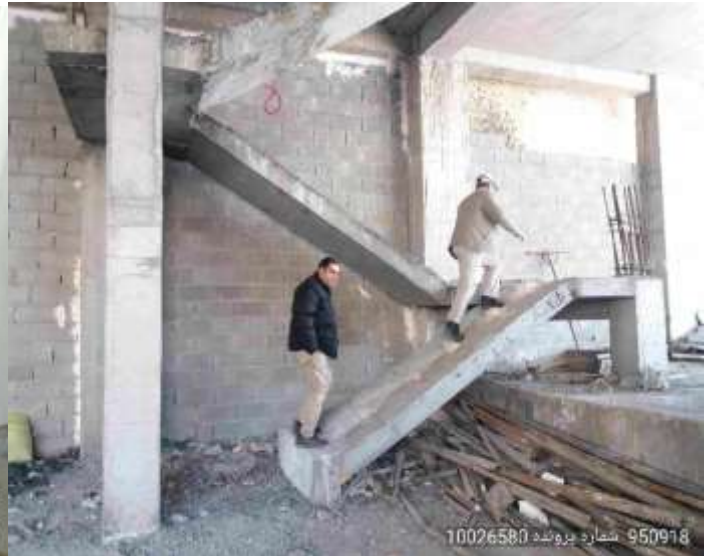
شکل ۲۱-۲ عدم اجرای نرده حفاظتی و پاخور پرتگاه های طبقات
