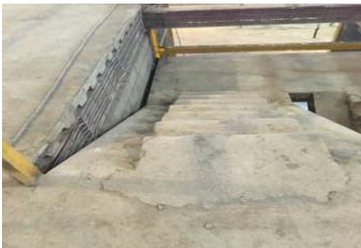
شکل ۲-۱۲ عدم اجرای نرده حفاظتی و پاخورپرتگاه های طبقات
