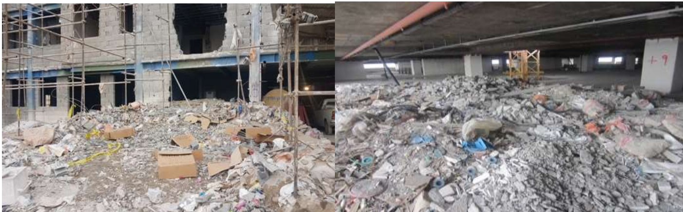
اشکال ۱۲-۱- ۱۲-۲- مربوط به بی نظمی کارگاه و وضعیت نامناسب دیو نخاله ها و مصالح و وضعیت نایمن ۵S
