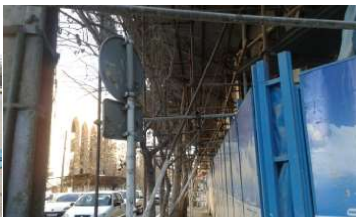
شکل ۱-۳ مسدود کردن پیاده رو وعدم اجرای راه دسترسی موقت
