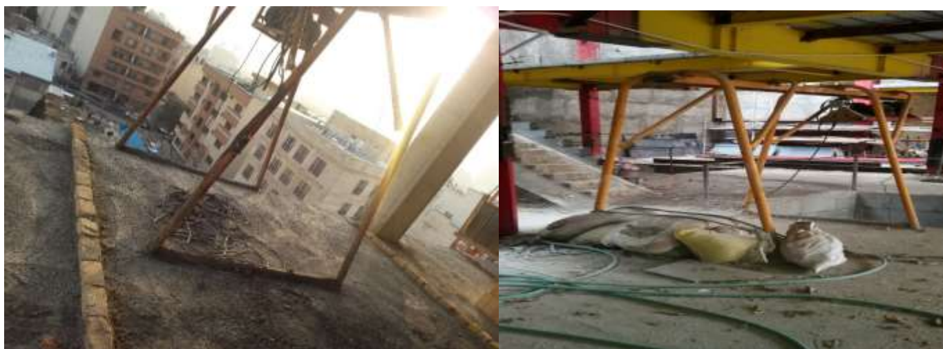
شکل ۱-۶-۲ و ۶-۳ عدم اتصال مناسب پایه های بالابر و خطرات واژگونی ناشی از چرخش وافتادن
