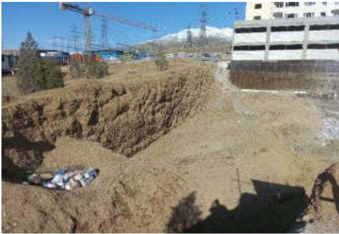
شکل ۲۰-۲ عدم اجرای نرده حفاظتی و پاخور پرتگاه های طبقات
