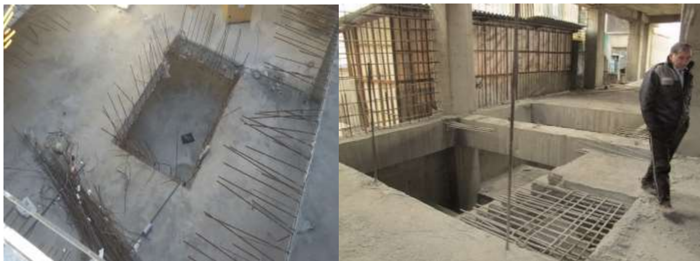
اشکال ۸-۳ و ۸-۴- عدم وجود نرده حفاظتی مناسب برای پرتگاه ها
