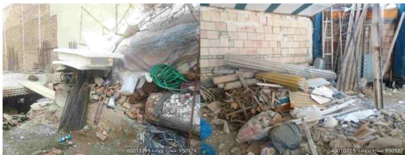
اشکال ۱۵-۱۲-۱۶ مربوط به بی نظمی کارگاه و وضعیت نامناسب دیو نخاله ها و مصالح و وضعیت نایمن S۵
