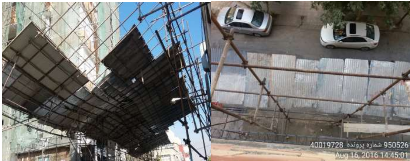
اشکال ۵-۱۳ و ۶-۱۳- عدم اجرای پوشش مناسب و ایمن سپر حفاظتی و سرپوش محافظتی
