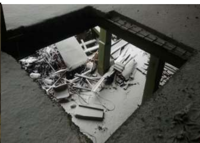
اشکال ۸-۱۳ و ۸-۱۴- عدم وجود نرده حفاظتی مناسب برای پرتگاه ها
