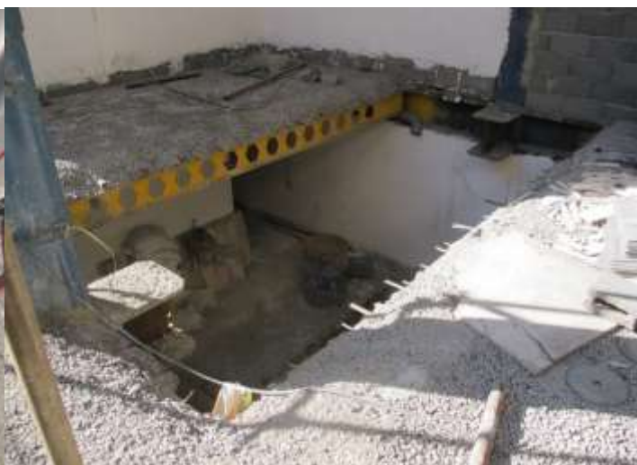
شکل ۱۷-۲ عدم اجرای نرده حفاظتی و پاخور پرتگاه های طبقات
