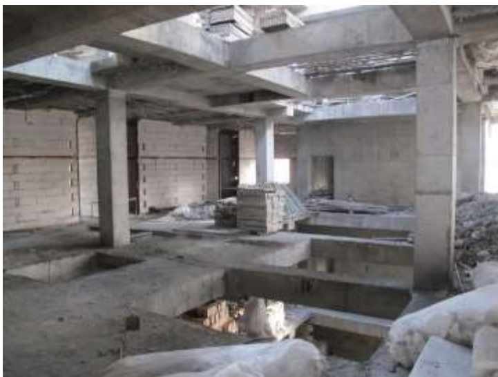
شکل ۱۴-۲ عدم اجرای نرده حفاظتی و پاخور پرتگاه های طبقات
