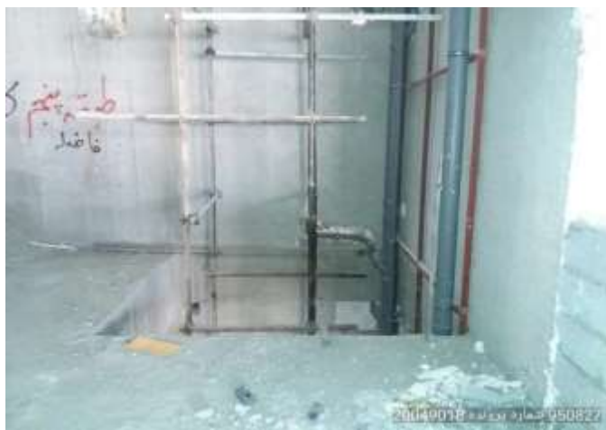
اشکال ۸-۱۱ و ۸-۱۲- عدم وجود نرده حفاظتی مناسب برای پرتگاه ها
