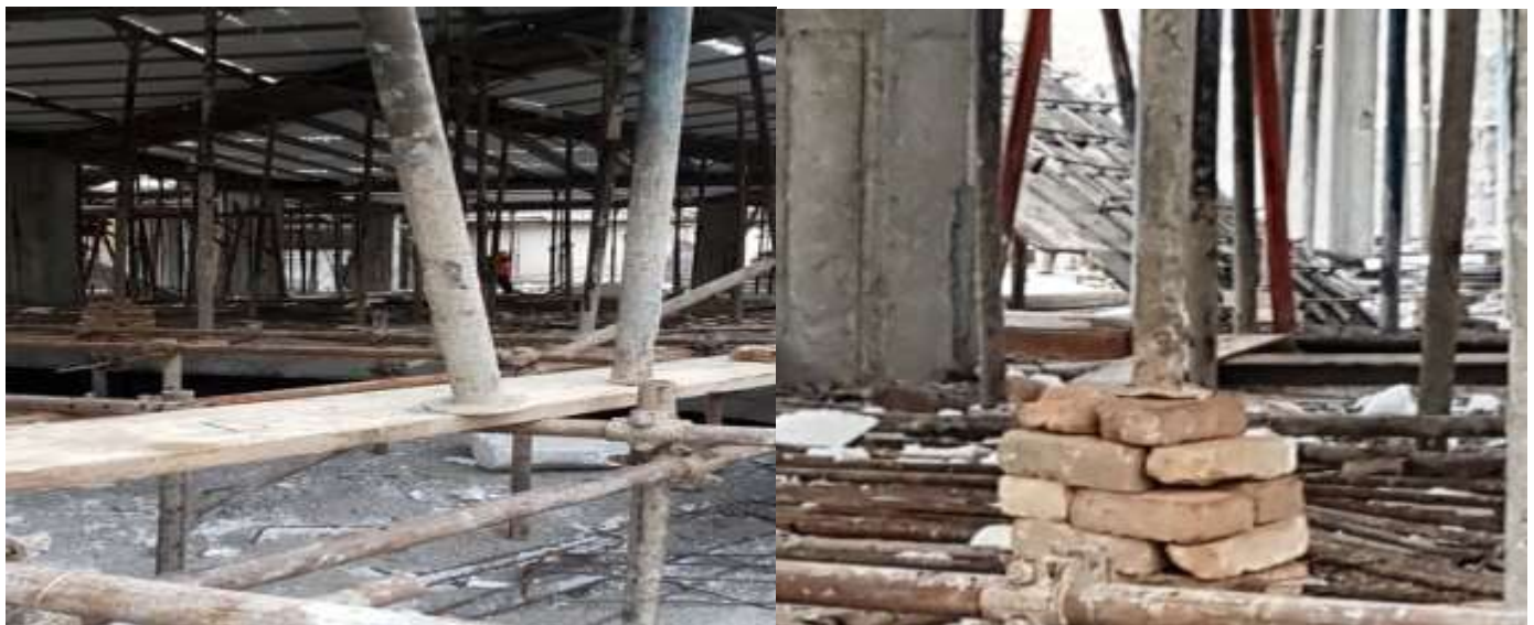
اشکال ۳-۳-۳ و ۳-۴- نحوه اشتباه پرکردن زیر داربست ها وجک ها با استفاده ازچوب وآجر وعدم تراز نمودن باستفاده از صفحه فلزی
