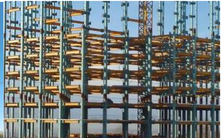
شکل ۲-۵ عدم اجرای نرده حفاظتی و پاخور پرتگاه های طبقات
