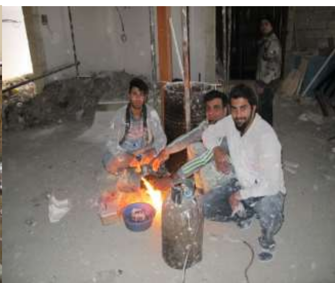
اشکال ۱۳-۴ و ۱۴-۴- عدم استفاده از تجهیزات حفاظت فردی مناسب
