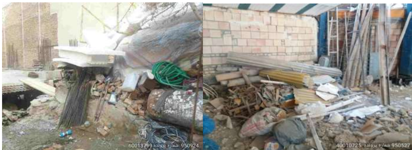
اشکال ۱۲-۳- ۱۲-۴- مربوط به بی نظمی کارگاه و وضعیت نامناسب دیو نخاله ها و مصالح و وضعیت نایمن ۵S
