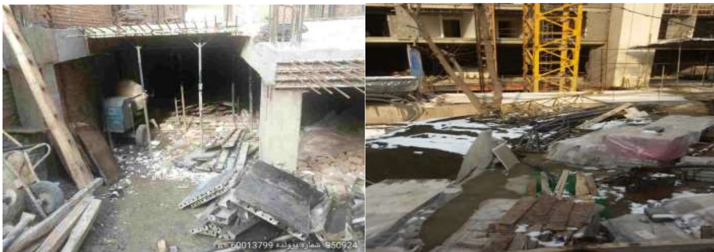
اشکال ۱۳-۱۲-۱۴ مربوط به بی نظمی کارگاه و وضعیت نامناسب دیو نخاله ها و مصالح و وضعیت نایمن S۵
