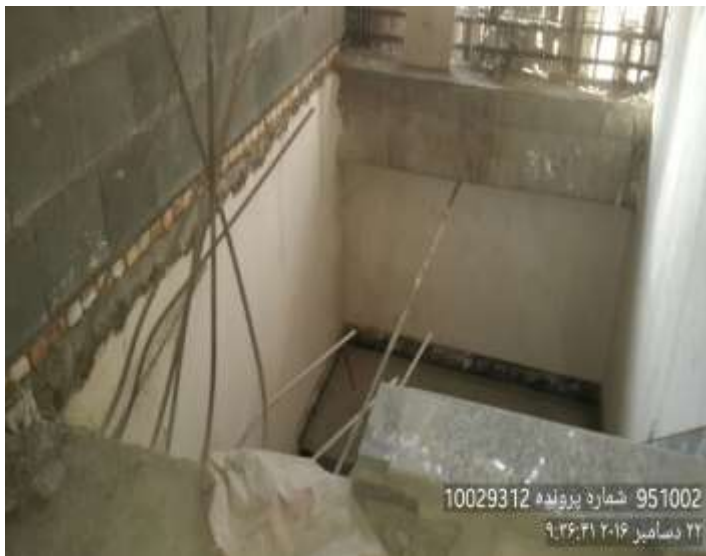
شکل ۲۲-۲ عدم اجرای نرده حفاظتی پرتگاه های طبقات
