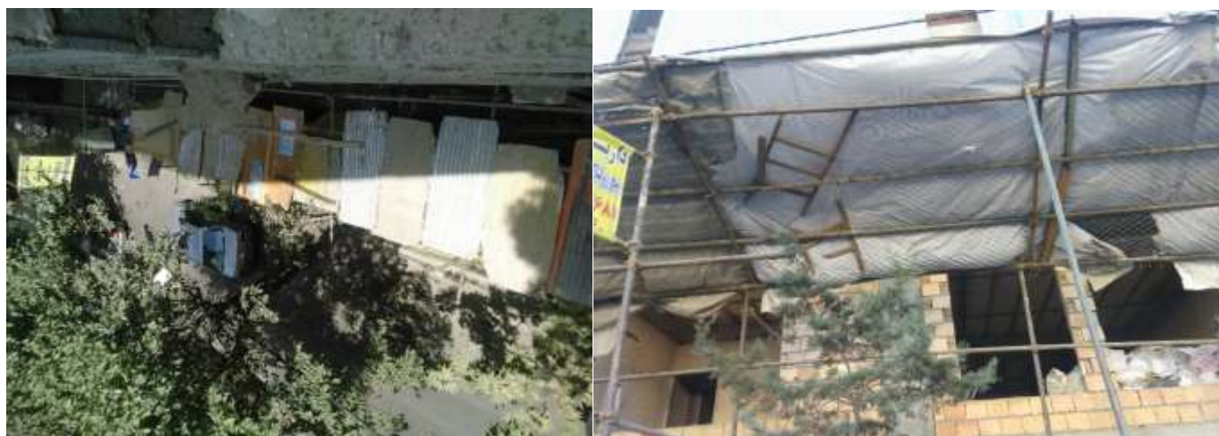
اشکال ۱۳-۱۳ و ۱۴-۱۳- عدم اجرای پوشش مناسب و ایمن سپر حفاظتی و سرپوش محافظتی
