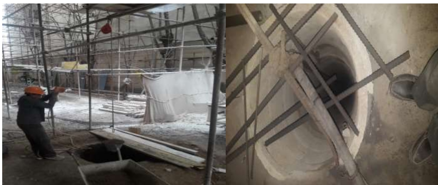
شکل ۱-۷ و ۲-۷ - عدم وجود سرپوش حفاظتی مناسب بر روی دهانه چاه
