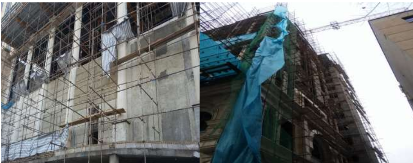
اشکال ۱۵-۱۳ و ۱۶-۱۳- عدم اجرای پوشش مناسب و ایمن نما
