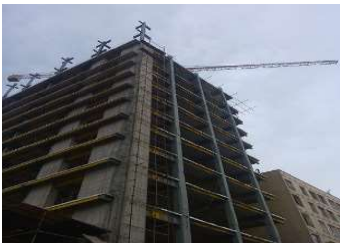
شکل ۲۴-۲ عدم اجرای نرده حفاظتی و پاخور پرتگاه های طبقات
