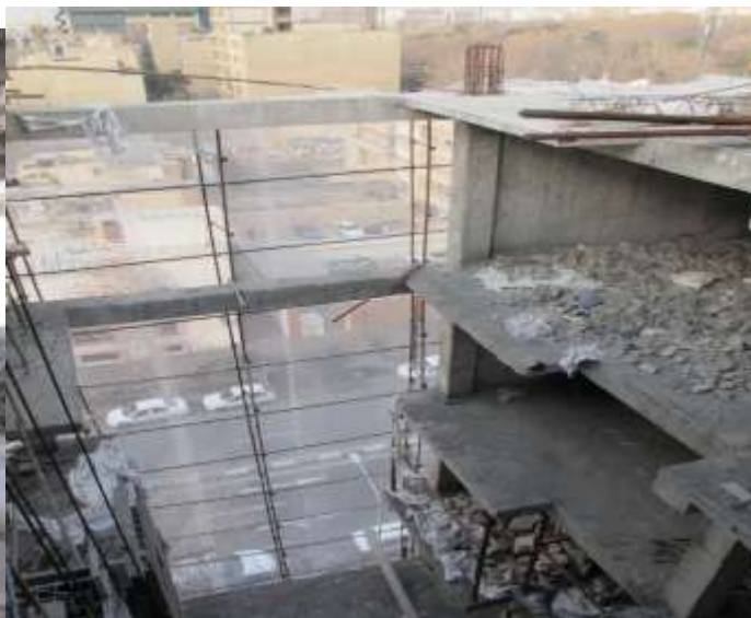
شکل ۱۳-۲ عدم اجرای نرده حفاظتی و پاخور پرتگاه های طبقات
