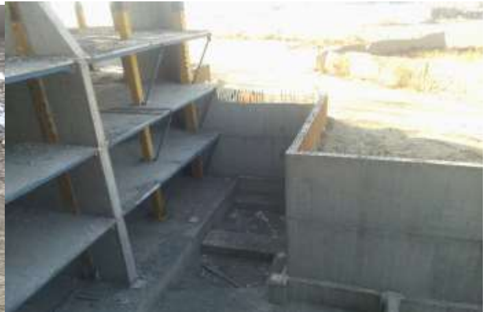
شکل ۲-۳ عدم اجرای حفاظ و پاخور مناسب طبقات
