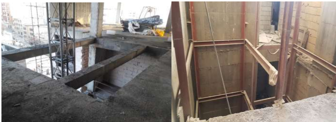
اشکال ۸-۱ و ۸-۲- عدم وجود نرده حفاظتی مناسب برای پرتگاه ها
