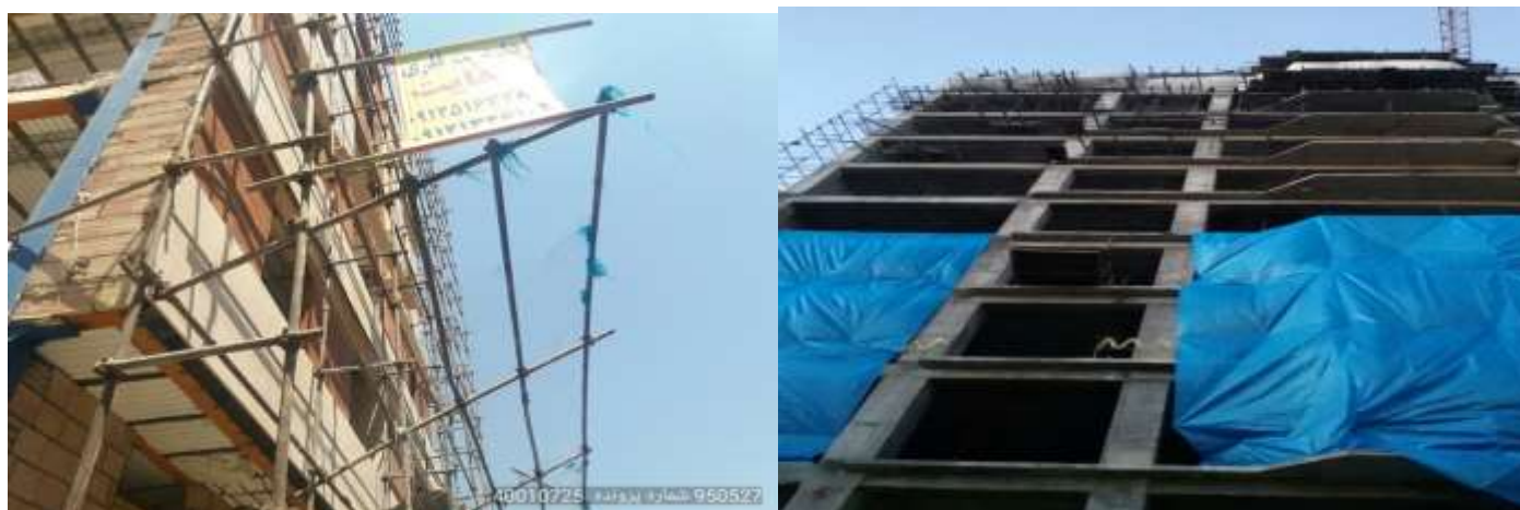
اشکال ۷-۱۳ و ۸-۱۳- عدم اجرای پوشش مناسب و ایمن نما
