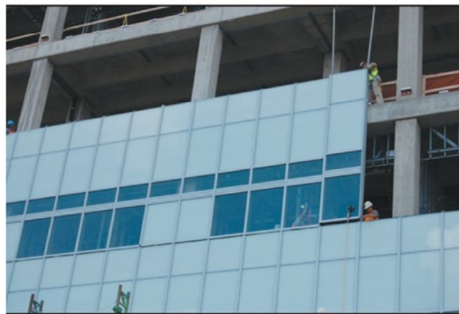
قطعه جدید با اتصال وادارهای قطعه فوقانی به وصله های قطعه پایینی نصب می شود. این وصله ها جهت توسعه نما و همچنین ایجاد مقاومت در برابر بار جانبی کاربرد دارند.
