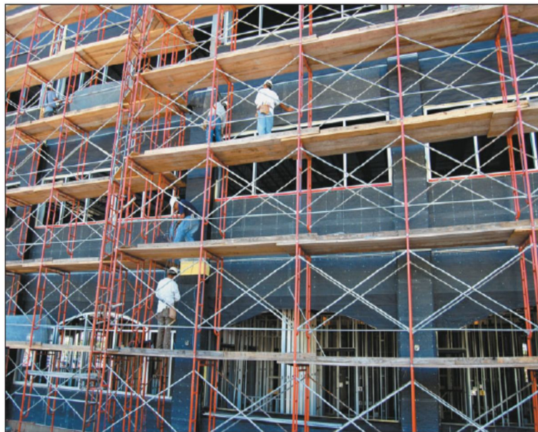
شکل ۶-۳- نمای یک ساختمان ۵ طبقه پوشانده شده با استفاده از داربست به منظور اجرای نمای سیمانی
