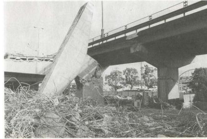
شکست خمشی - برشی پایه زلزله ۱۹۹۵ کوبه
