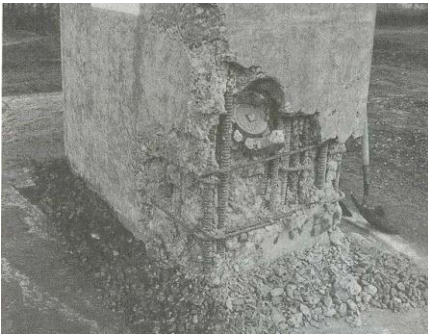
شکست پیوستگی وصله های پوششی پای ستون زلزله ۱۹۸۹ لوما پریتا
