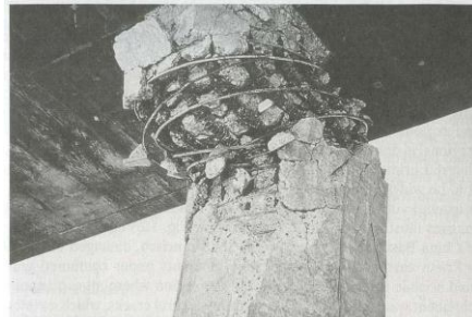
شکست برشی ستون زلزله ۱۹۷۱ سن فرناندو
