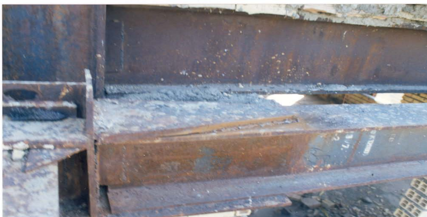
وضعیت جوش اتصالات قبل از اجرای طرح تقویت و بهسازی
