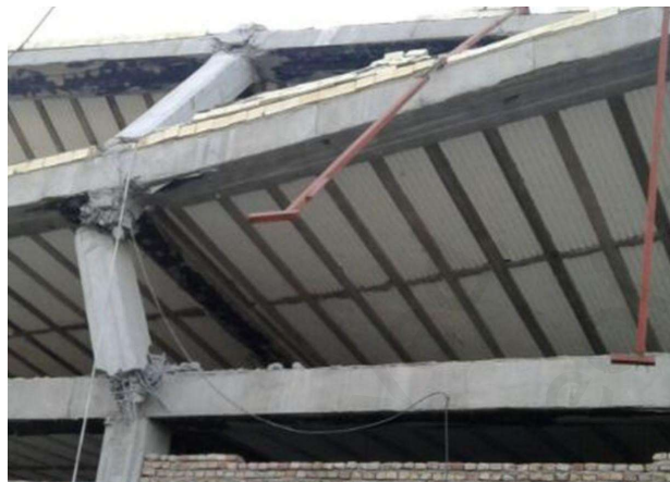
ساختمان بتنی در سرپل ذهاب که به دلیل ایجاد لولای خمیری در ستونها و در زلزله ۲۱ آبان ۱۳۹۶ منهدم شد
