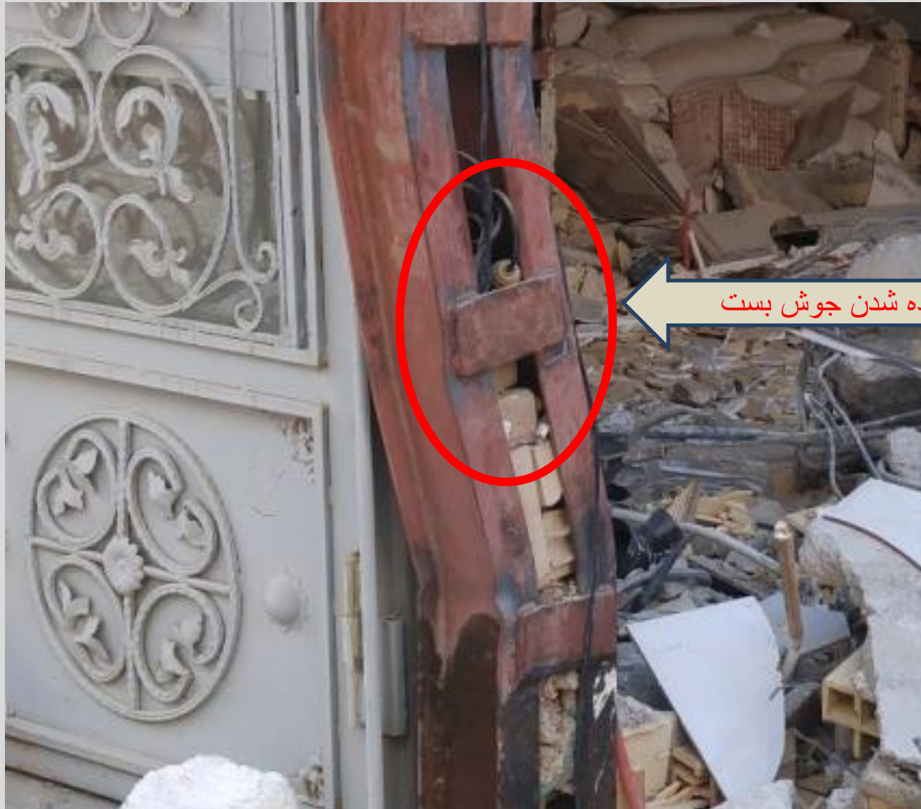
جوش نامناسب و ضعیف قیدها
