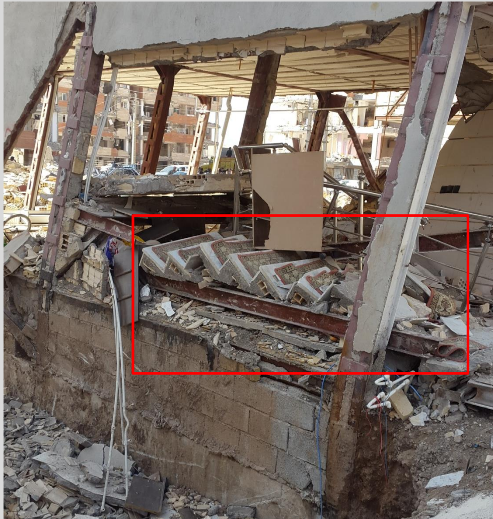
ضعف راه پله ها در حرکت های جانبی زلزله
