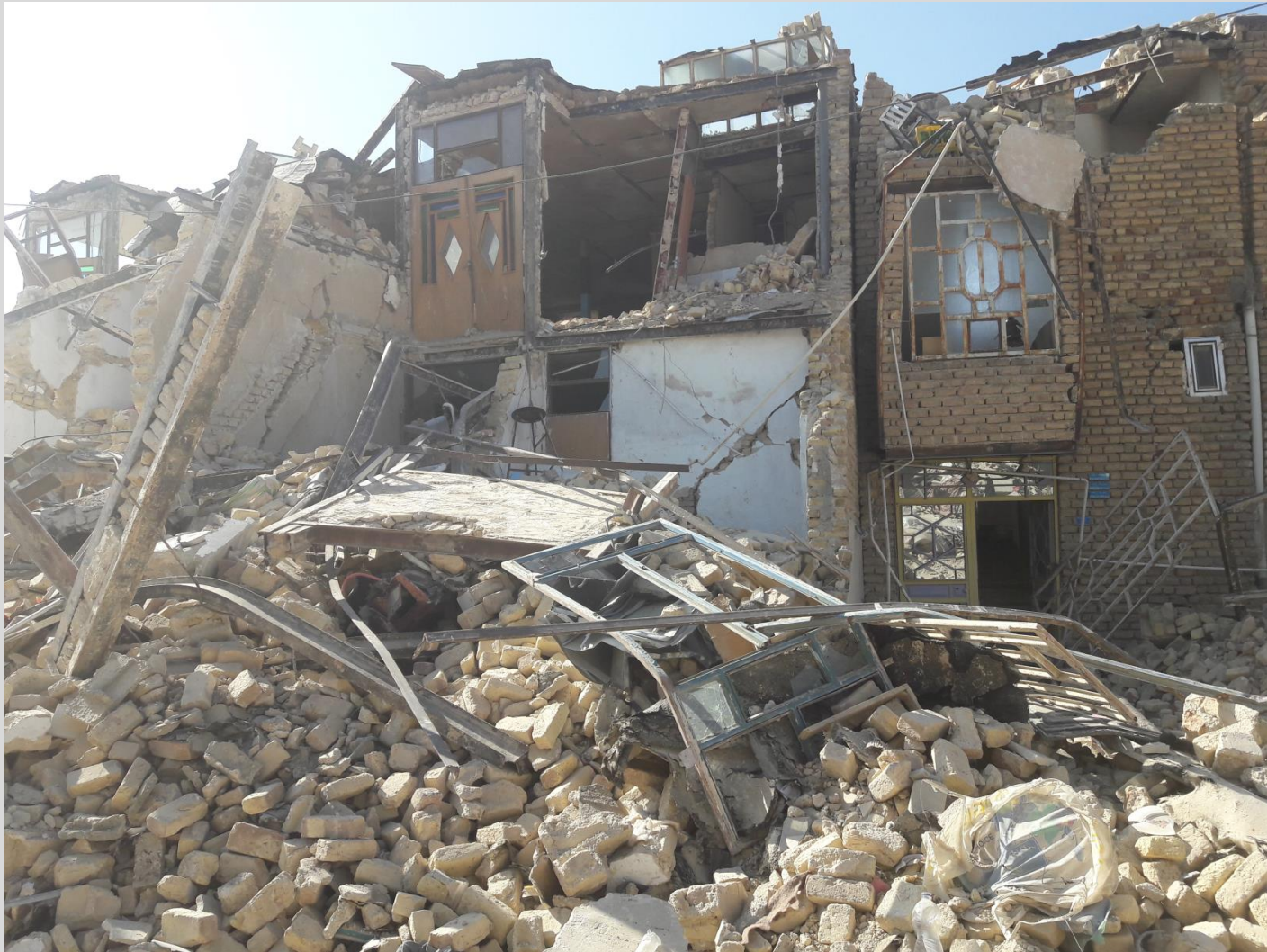
ضعف اعضای سازه، عدم وجود مهار جانبی کافی و تخریب کل سازه
