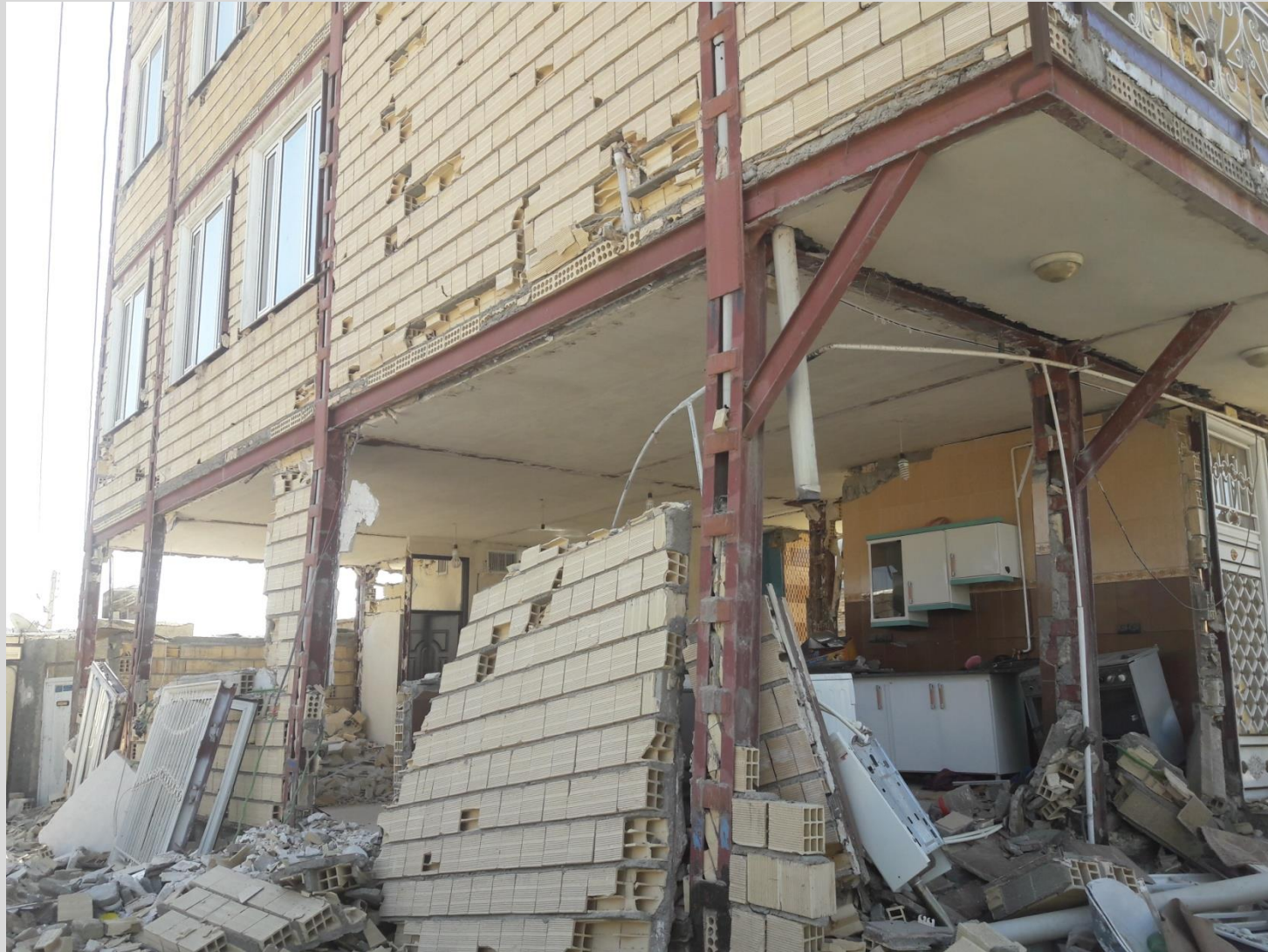
تخریب دیوارهای غیر سازه ایی بدلیل عملکرد میانقابیی و فقدان نبشی کشی کلاف بندی (وال پست)
