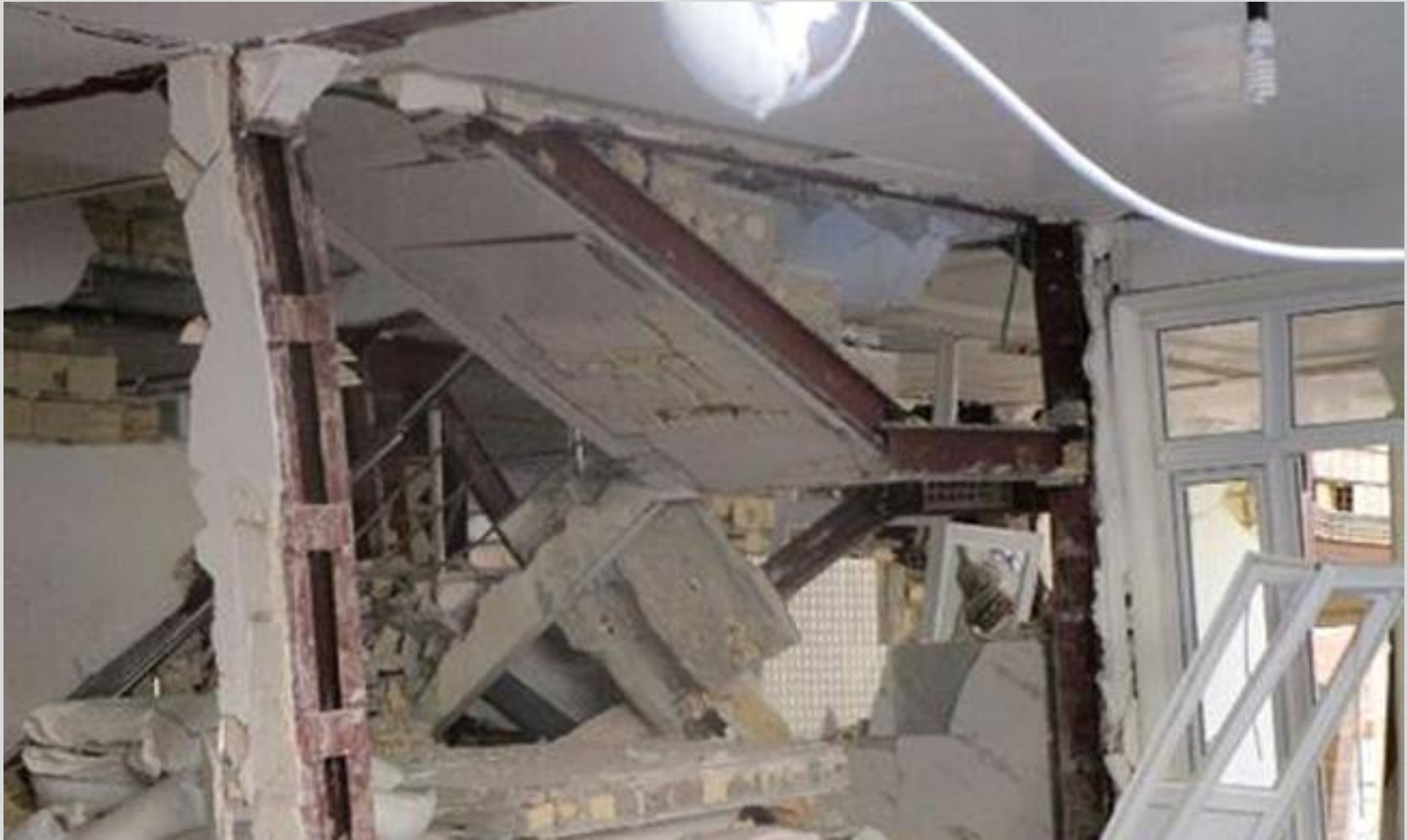
تخریب دیوارهای غیر سازه‌ای بدلیل عملکرد میانقابی
