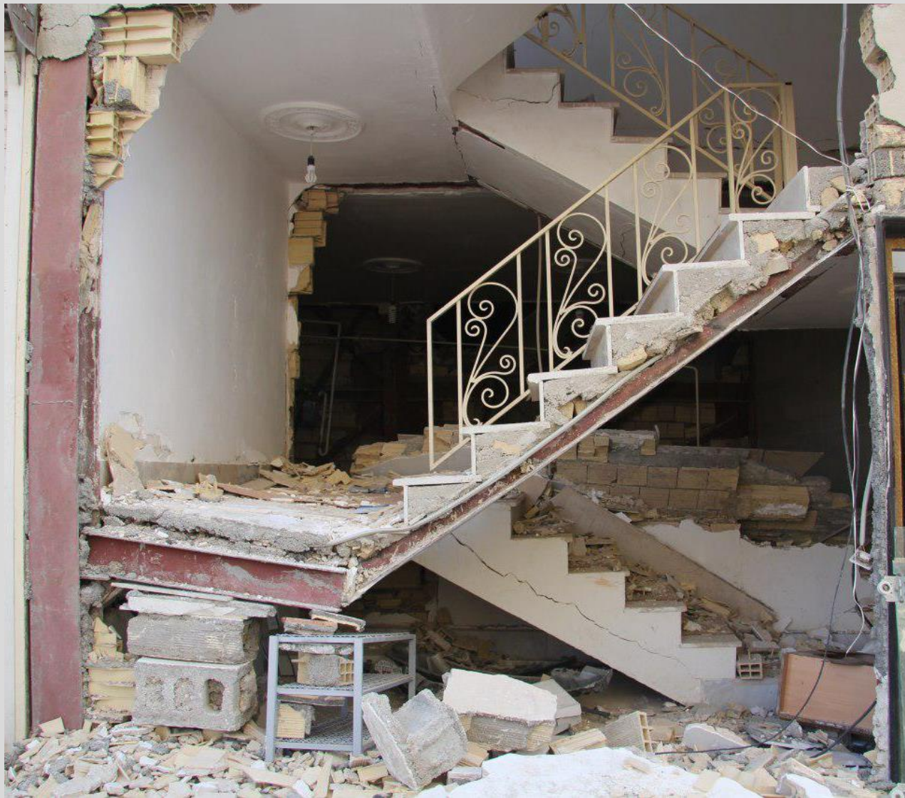
ضعف راه پله ها در حرکت‌های جانبی زلزله
