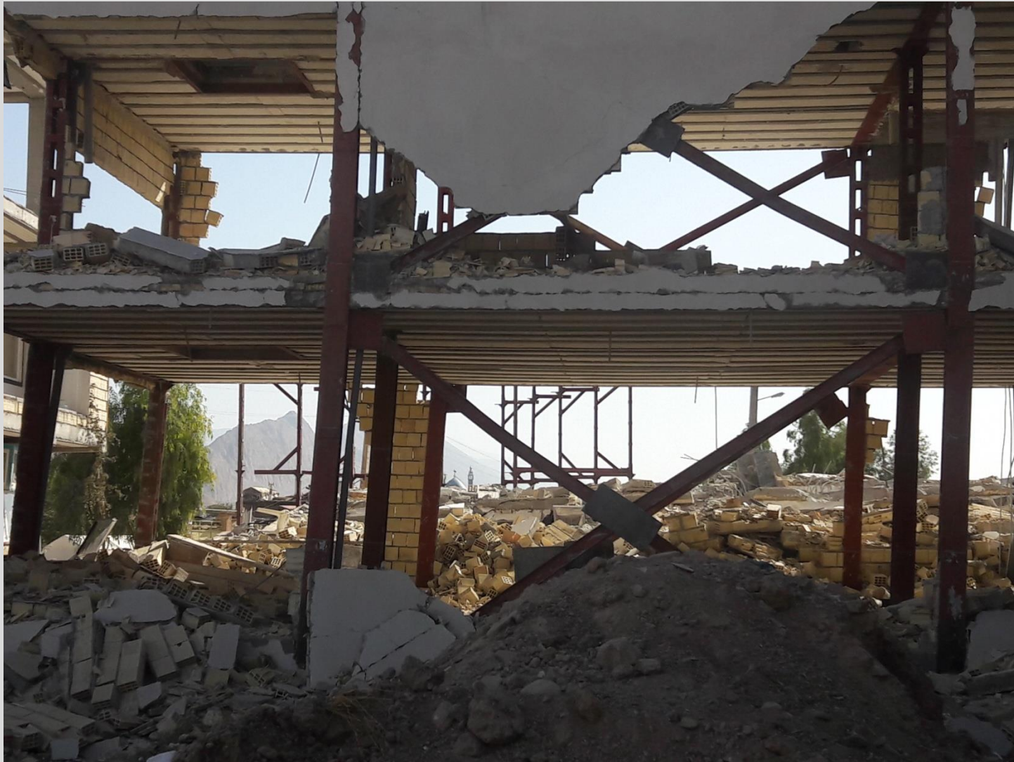
تخریب دیوارهای غیر سازه‌ای بدلیل عملکرد میانقاب‌ی و فقدان نبشی کشی کلاف بندی (وال پست)
