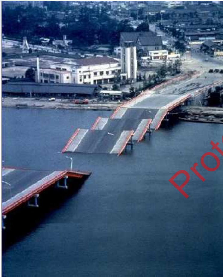
نشست خاک بستر پایه پل بر اثر روانگرایی
