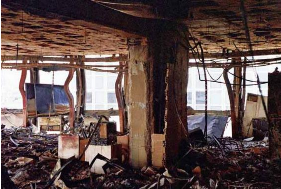
کمانش ستون ها تحت اثر نیروی زلزله
