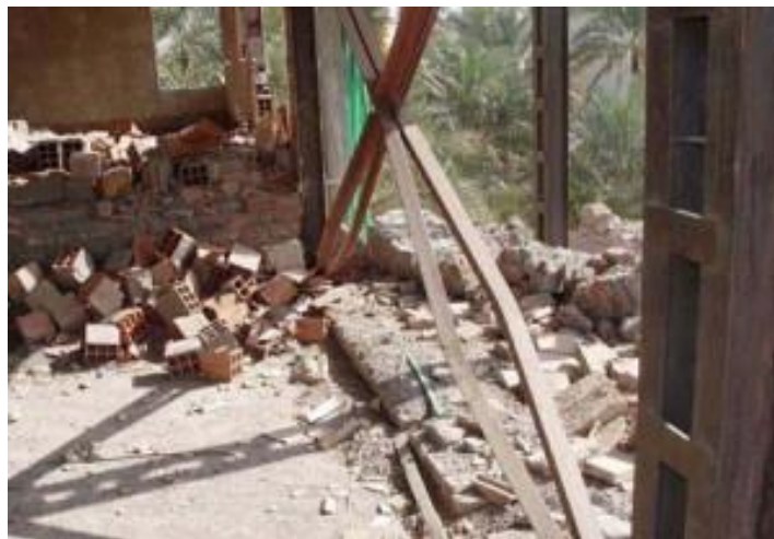
کمانش کلی مهاربندها تحت زلزله
